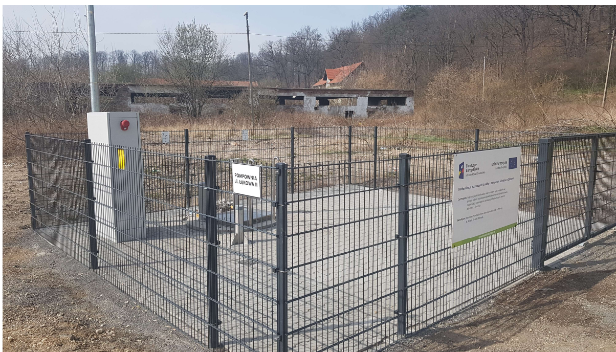
Zdjęcie nr 36 Pomownia ścieków przy ul. Łąkowej II po modernizacji
