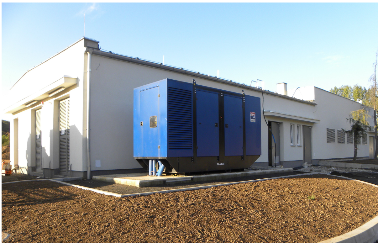
Zdjęcie nr 14 Budynek stacji transformatorowej i dmuchaw po modernizacji
