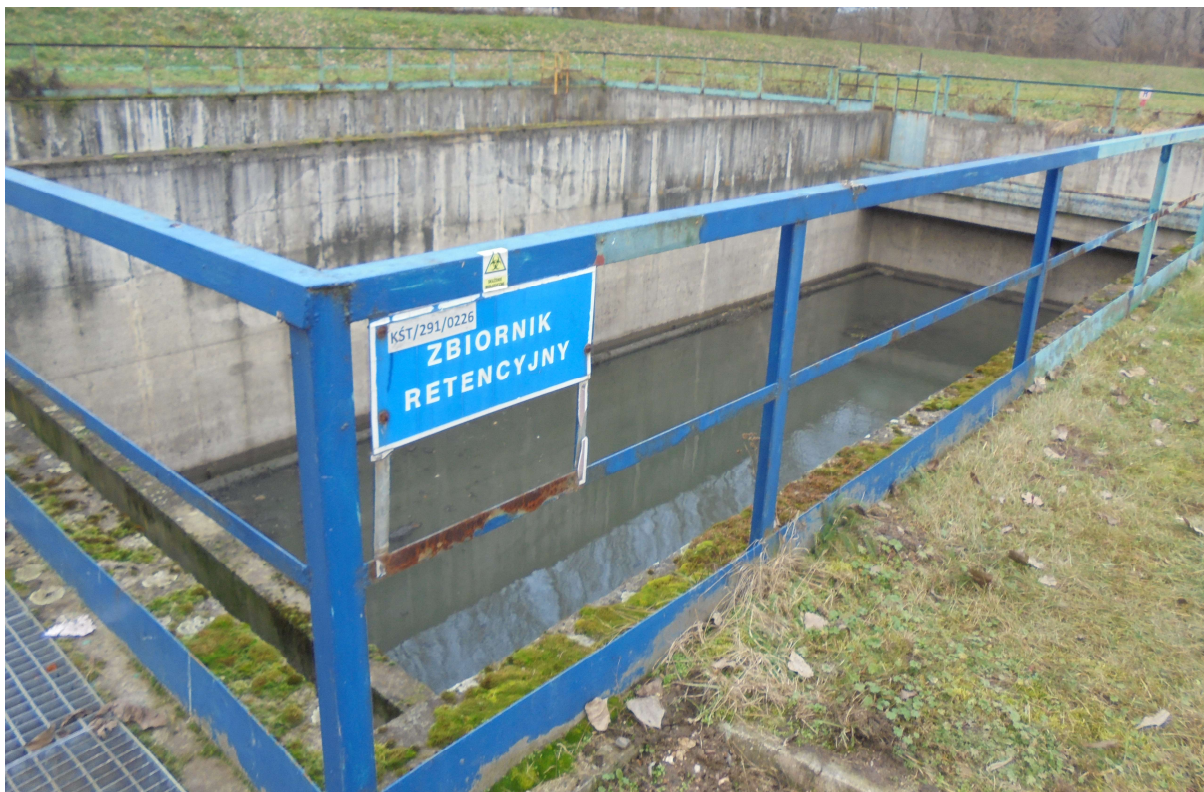
Zdjęcie nr 3 Zbiornik retencyjny przed modernizacją
