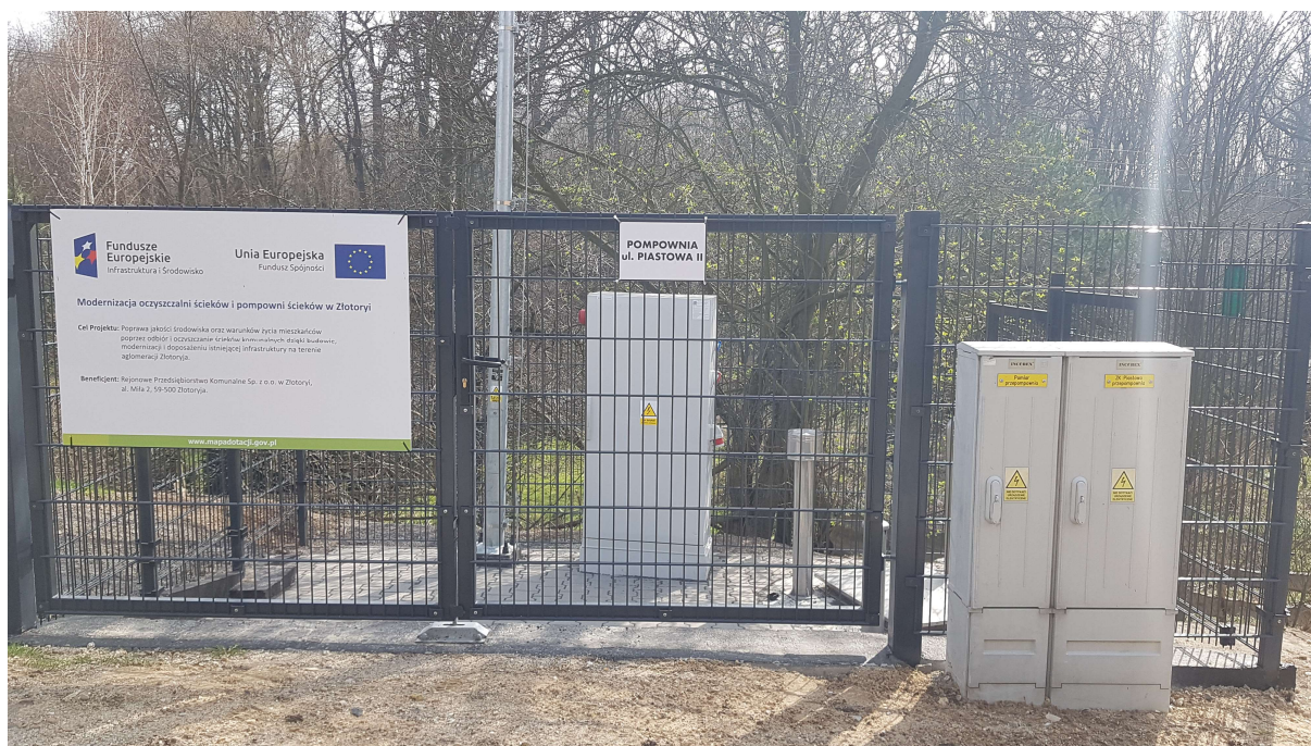
Zdjęcie nr 32 Pompownia ścieków przy ul. Piastowej II po modernizacji
