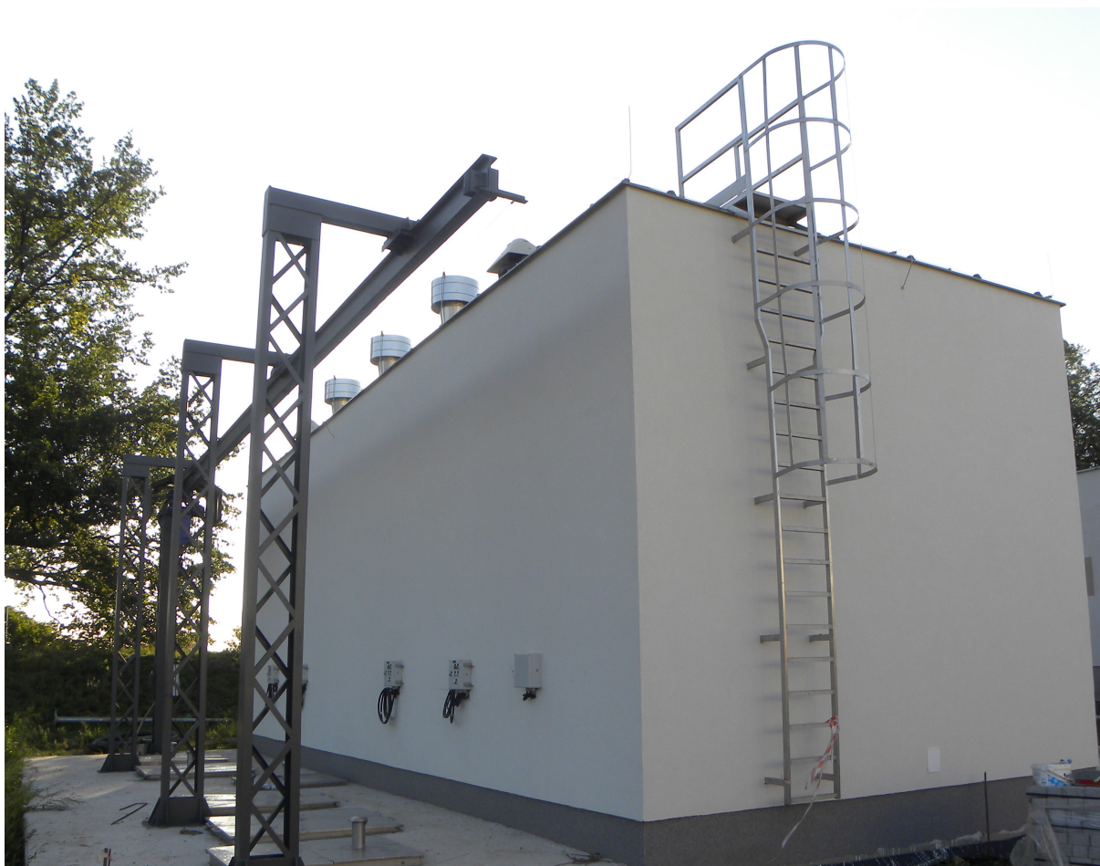
Zdjęcie nr 10 Pompownia osadu recyrkulowanego i nadmiernego po modernizacji
