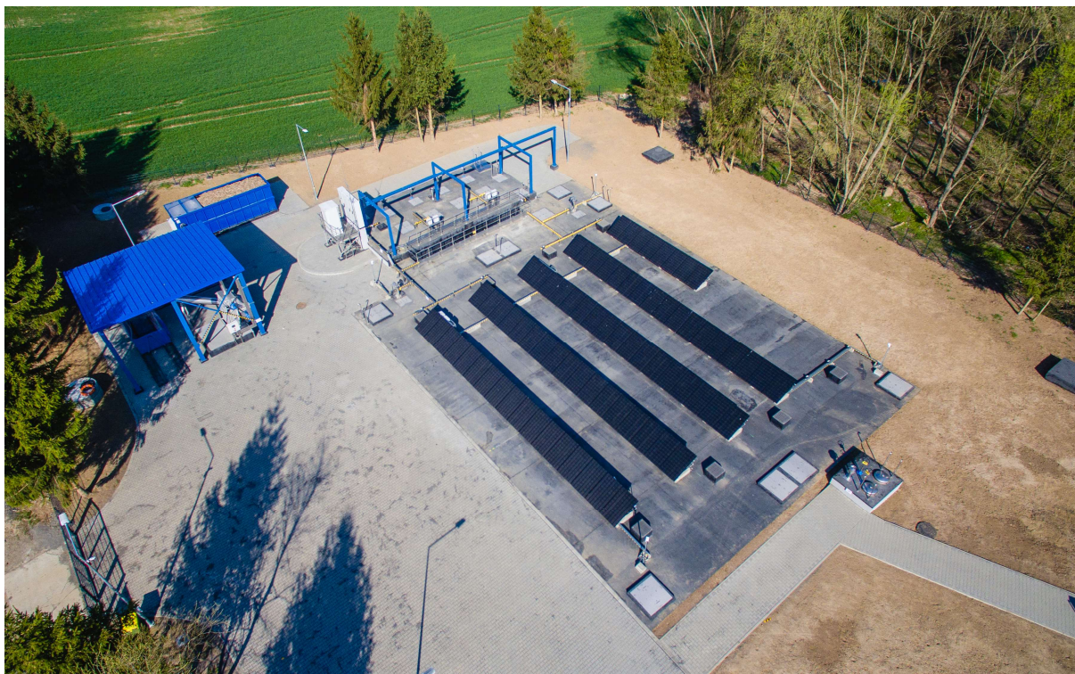
Zdjęcie nr 39 Panele fotowoltaiczne na pompowni ścieków Z-3 przy ul. Legnickiej
