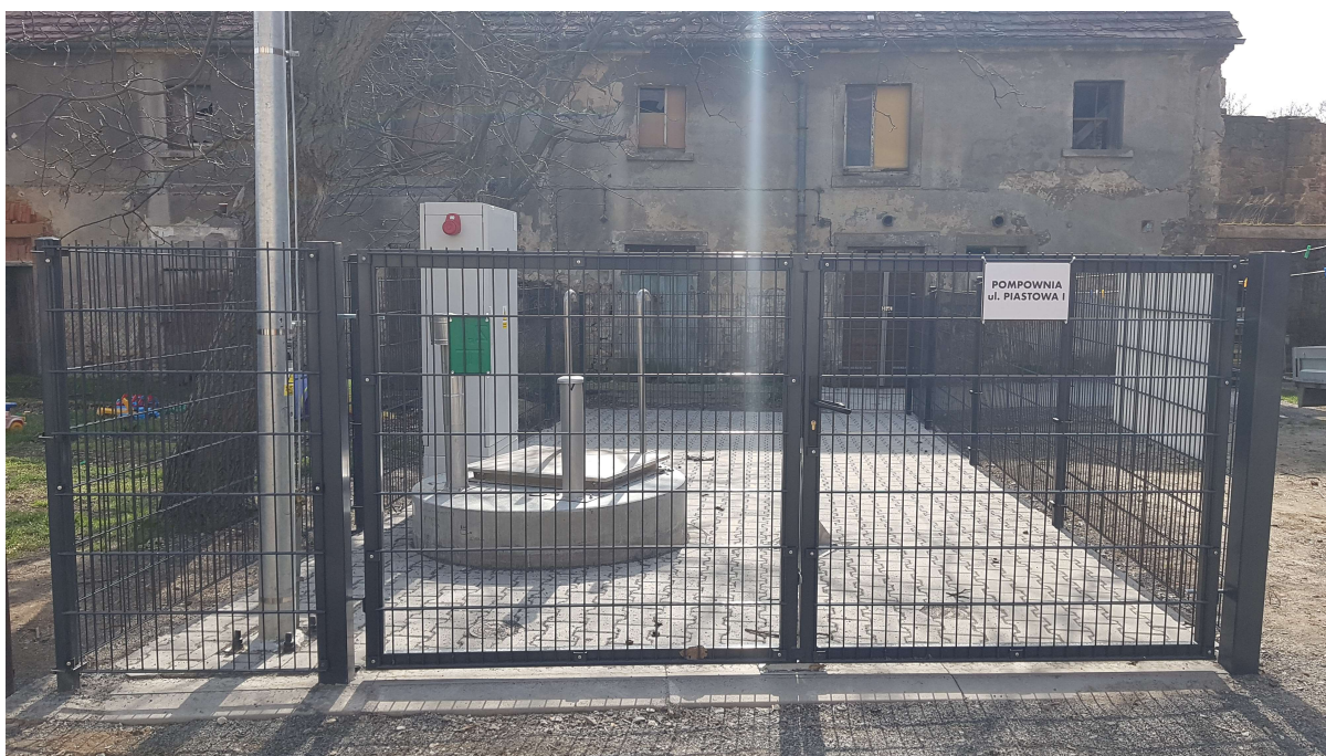
Zdjęcie nr 30 Pomownia ścieków przy ul. Piastowej I po modernizacji
