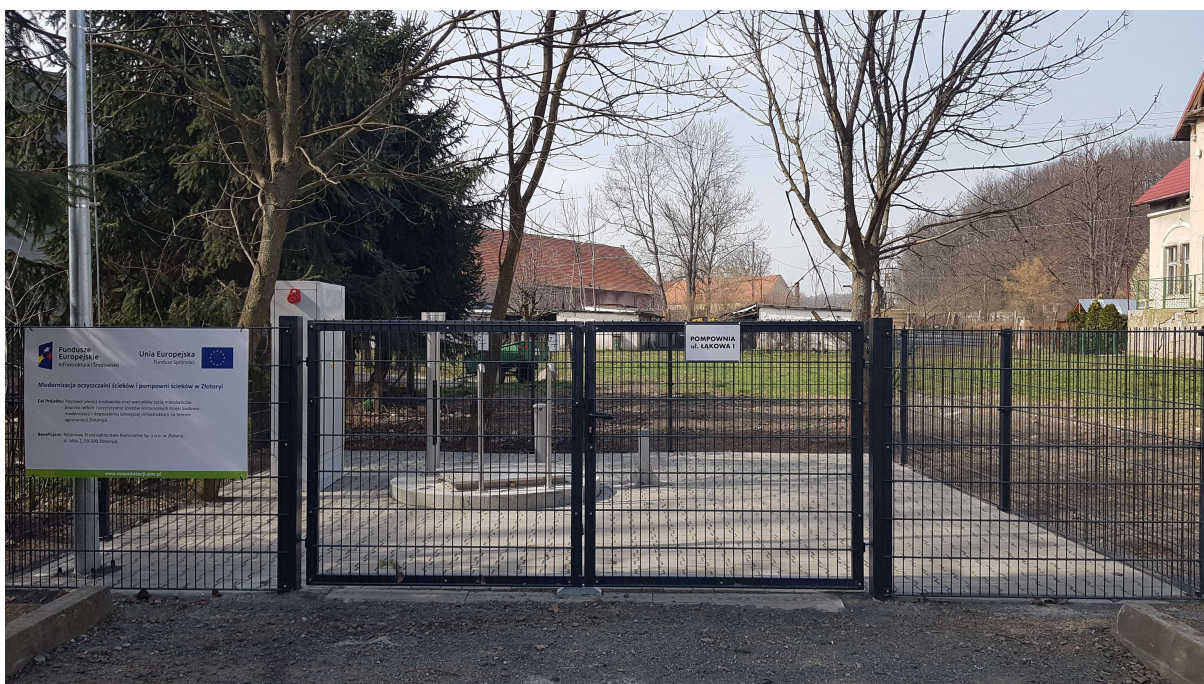
Zdjęcie nr 34 Pompownia ścieków przy ul. Łąkowej I po modernizacji
